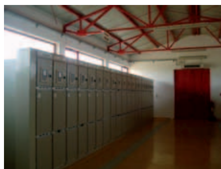
Slika 18 Sklopno postrojenje KSMA 24 – 630 A TS Mursko Središće
