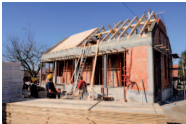
Slika 3 Izgradnja nove stambene zgrade prema tipskom projektu, studeni 2014., Izvor: Ministarstvo graditeljstva i prostornoga uređenja
