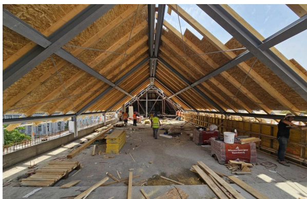
Slika 5 Povijesna drvena krovna konstrukcija Muzeja za umjetnost i obrt u Zagrebu zamijenjena čeličnom konstrukcijom (objekt pojedinačno zaštićeno kulturno dobro) [16]
