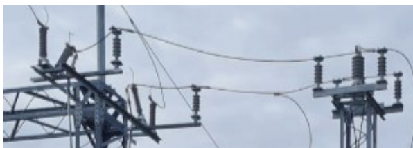
Slika 3 Rastavljači u isključenom i uključenom položaju
